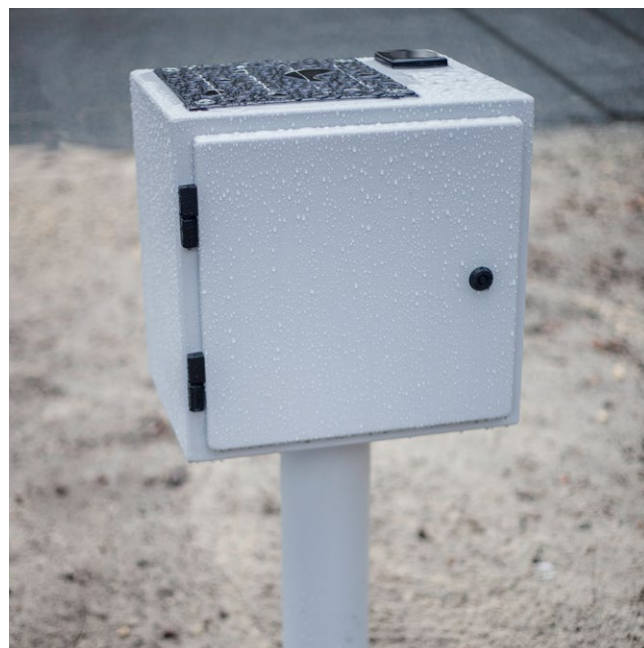
Weersbestendige kast met 3G-antenne en zonnepaneel.
